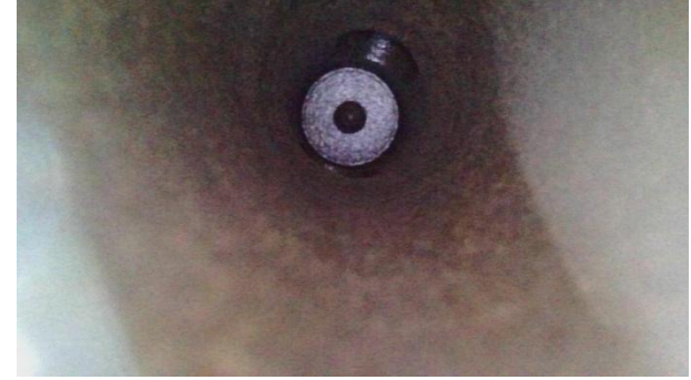
Innere eines Filterdüsenchafts in einem EntmanganungsfILTER
