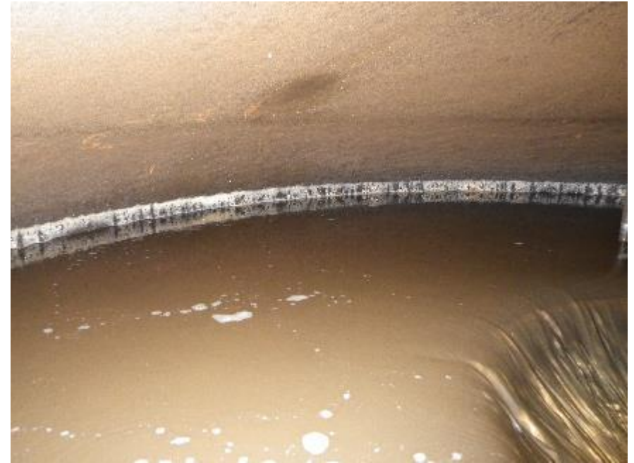
Gegen Ende der Wasserspülphase
