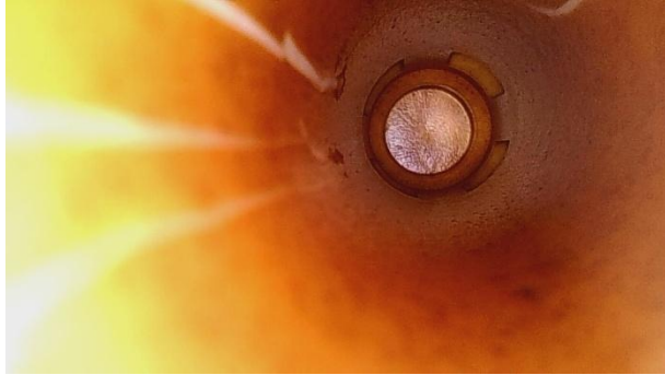
Innere eines Filterdüsenchafts in einem EnteisungsfILTER
